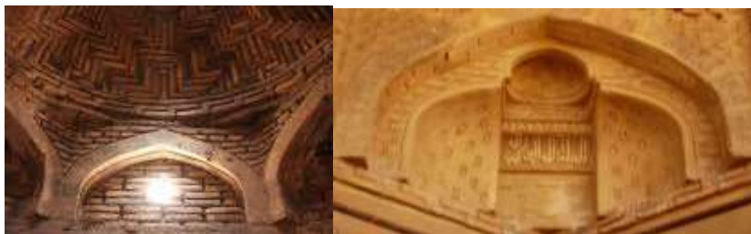
تصویر ۳- گوشه‌ای از رواق گنبدی شبستان صحن دوم رباط شرف، که ترکیبی از آجر و گچ می‌باشد. تصویر ۴- زاویه یک رواق گنبدی رباط شرف. منبع: نگارندگان
